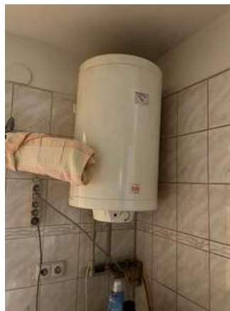
1.NP, zásobník teplej vody
